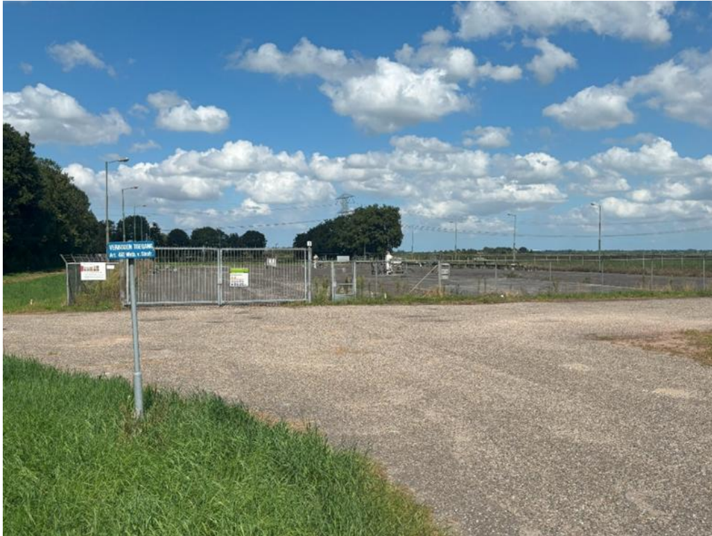
Gaswinningsveld bij de Tolberter Petten. foto: AV
